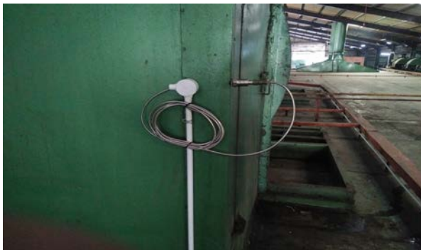
Figure 9a. Dryer fan (incoming)
